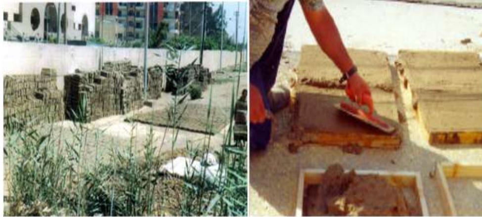
صورتان ( 9، 10) توضحان عملية صناعة الطوب فى تل بسطه لاستخدامه فى ترميم المعبد
